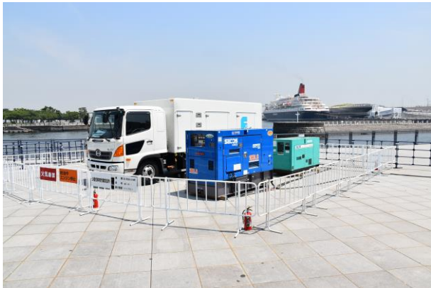
12. 電源車、発電機
